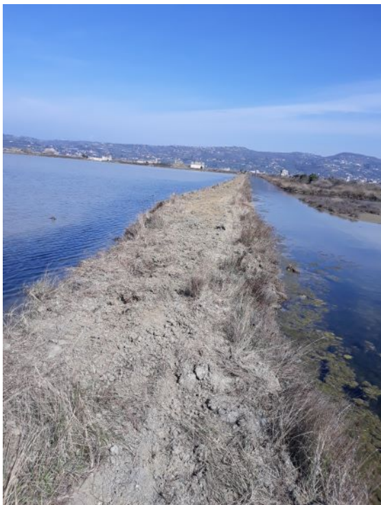
Dotrajan zemeljski nasip
